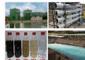
养殖废水处理工程 排放标准 (GB18596-2001) 四川省畜牧科学院绵阳试验基地 湖南新五丰股份有限公司养殖场
