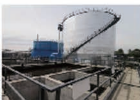
餐厨废水达标处理工程 3500m 3 发酵罐+污水达标处理 成都市青白江区 四川宜美长宇委
