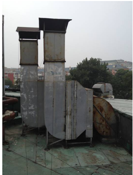
和平宾馆位于二层北侧楼顶的风机排口
