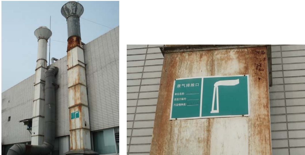
2#建筑物涂装工段排气筒（2 个，排气口高 16m）
